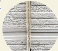
コーキングの劣化
